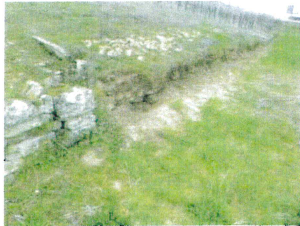
Abb. 13: Teilweise abgetragene Mauer mit Erdspalten im Biotop Nr. 169201182390.
